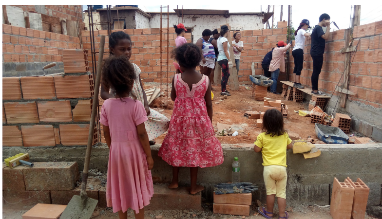
Figura 6. Oficina de construção para mulheres na Ocupação Rosa Leão Fonte: Arquivo pessoal da autora (2017).
